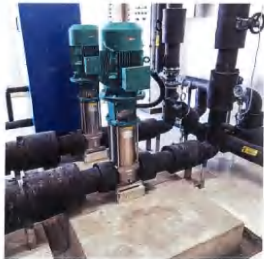
图 4.1-10 二次供水泵房
