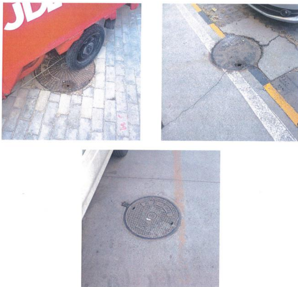
图 4.1-1 项目污水排口及雨水井
